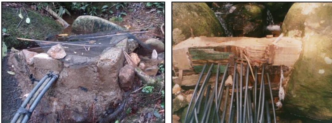
Figura 9- Imagens de captações alternativas com mangueiras na UGRHI 3
