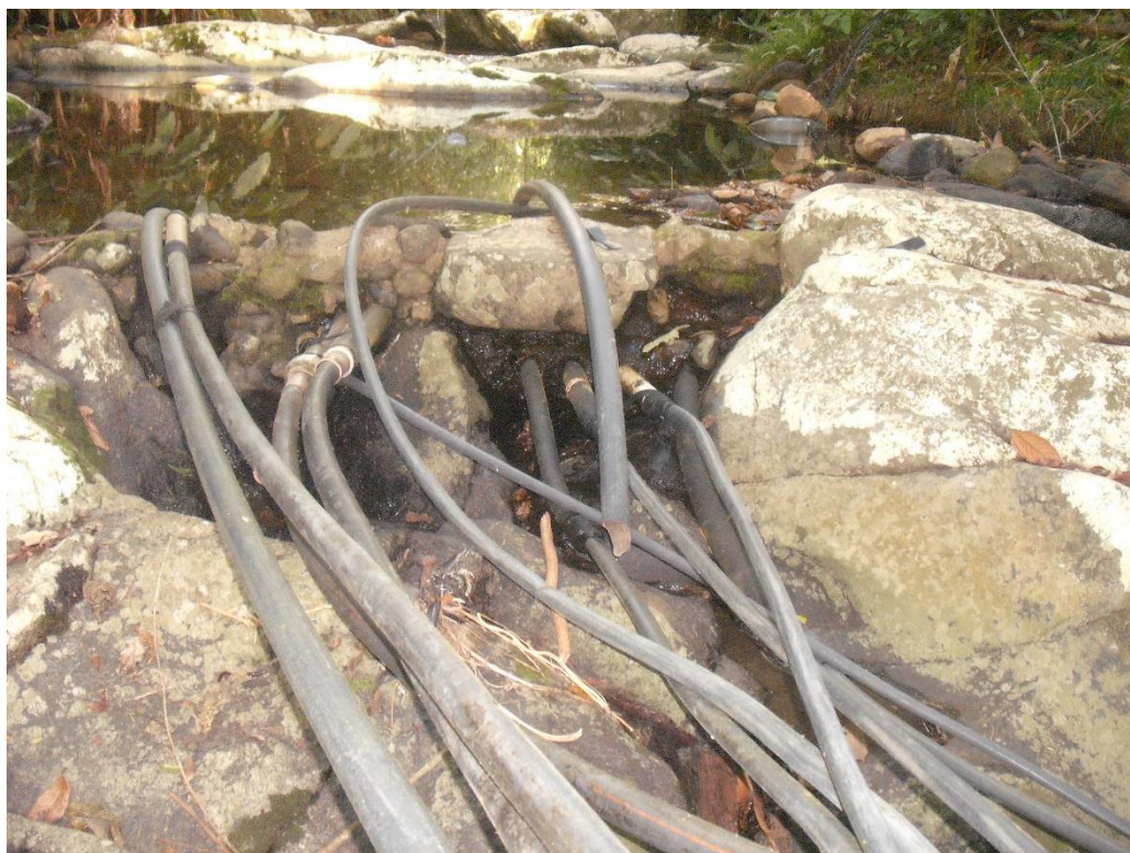
Figura 6: Captação de água da serra por meio de mangueiras. Fonte DAEE-BRB
