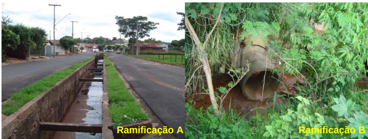
Figura 6.8 - Galeria (ramificação A) e tubulação (ramificação B).
