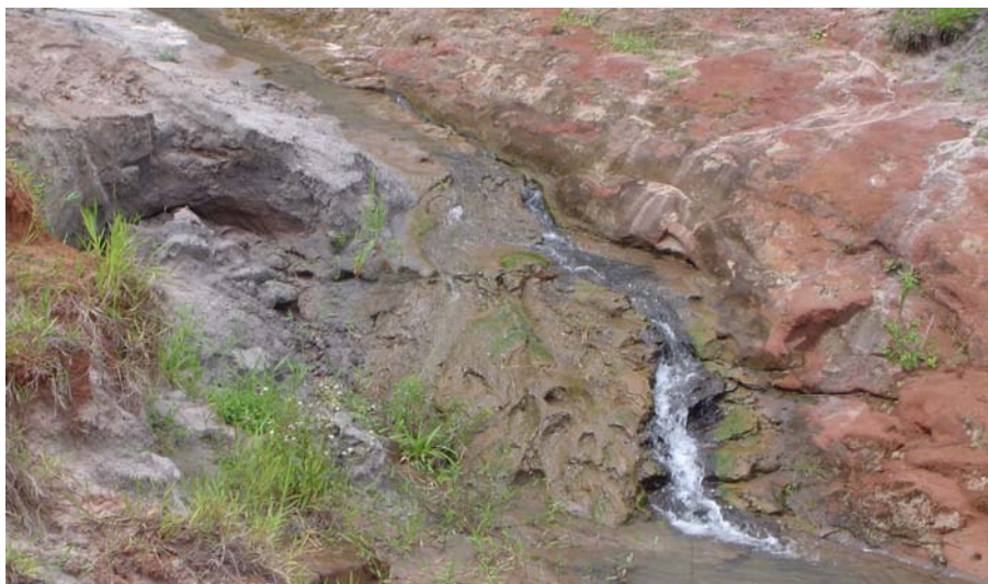
Figura 6.2 - Processo erosivo atingiu a rocha sã e o lençol freático.
