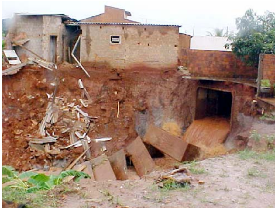
Figura 6.17 - Desabamento de moradias na cabeceira do córrego Jales.
