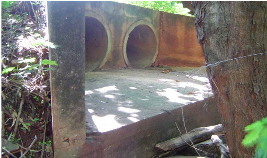
Figura 6.12 - Lançamento concentrado de águas superficiais e servidas por meio de duas tubulações.
